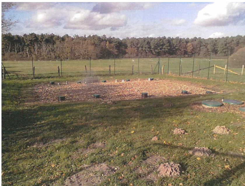
La station d'épuration
